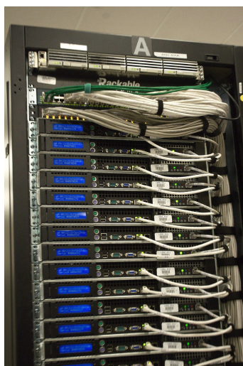
Arrière d'une baie de serveurs au centre de calcul NERSC : matérialité d'une infrastructure numérique. Wikimedia Commons, CC0.
