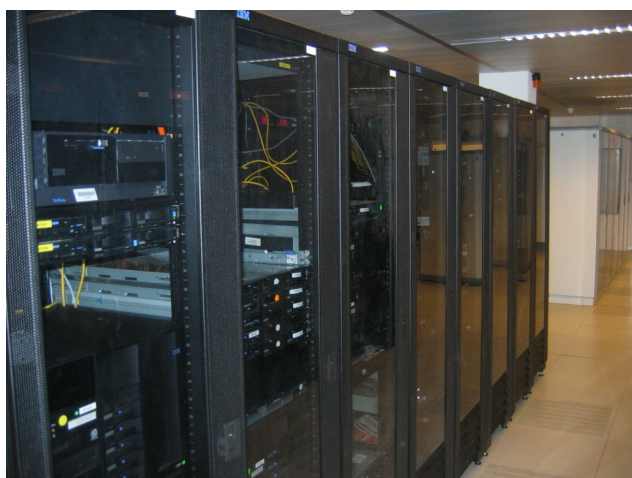
Centre de données : l'« immatériel » de l'IA reste une infrastructure de métal, de câbles, d'électricité, d'eau et de territoires. Photo : Wil Weterings, domaine public, Wikimedia Commons.
